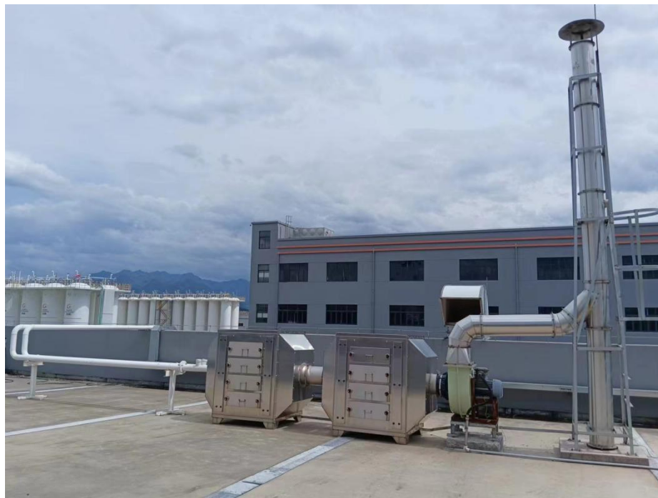
充装废气（含混配废气）处理设施（活性炭吸附）
