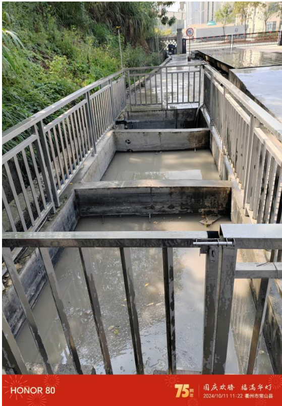
生产废水收集沉淀池
