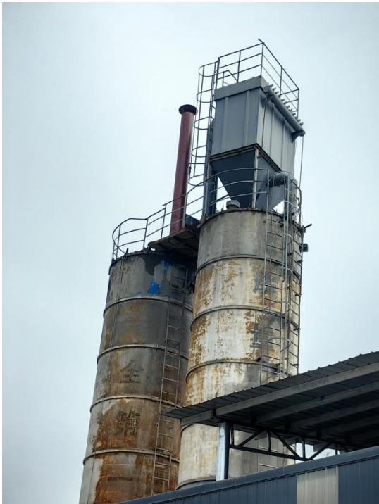
水泥筒仓呼吸废气处理设施（布袋除尘器）
