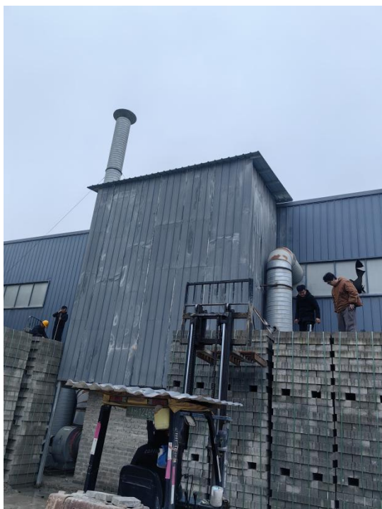
废矿渣破碎筛分粉尘废气处理设施 (布袋除尘)
