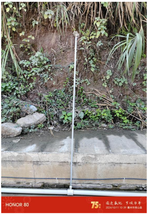
运输道路自动喷淋装置
