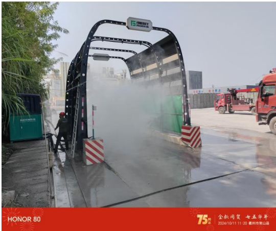
车辆冲洗设施
