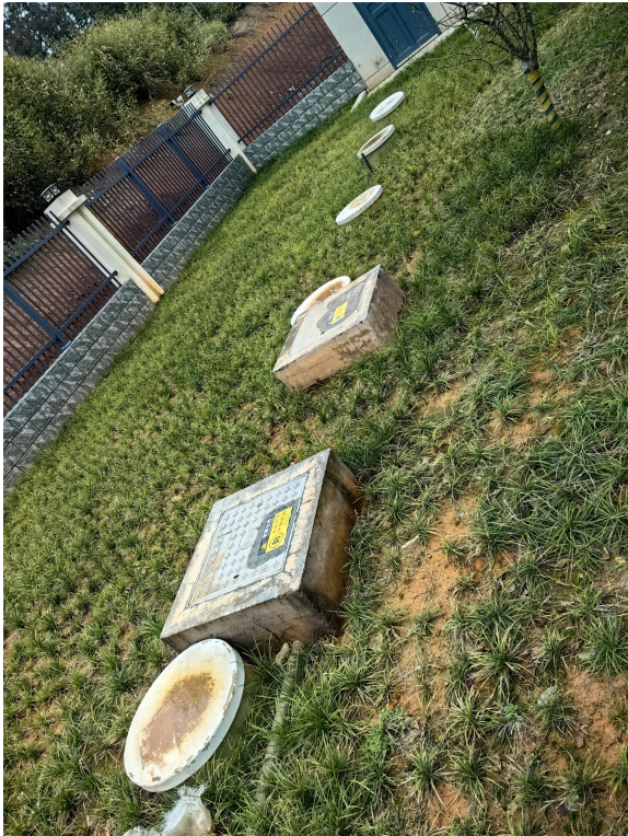
地下污水处理站
