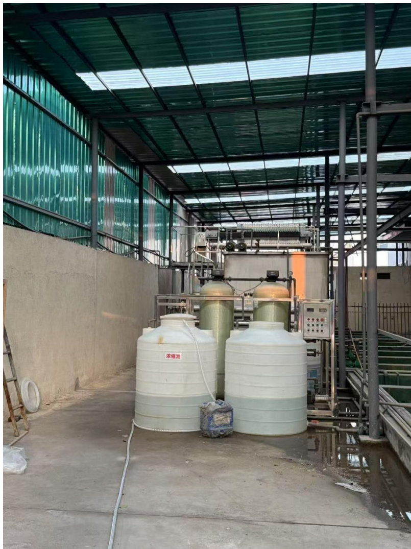
废水处理设施
