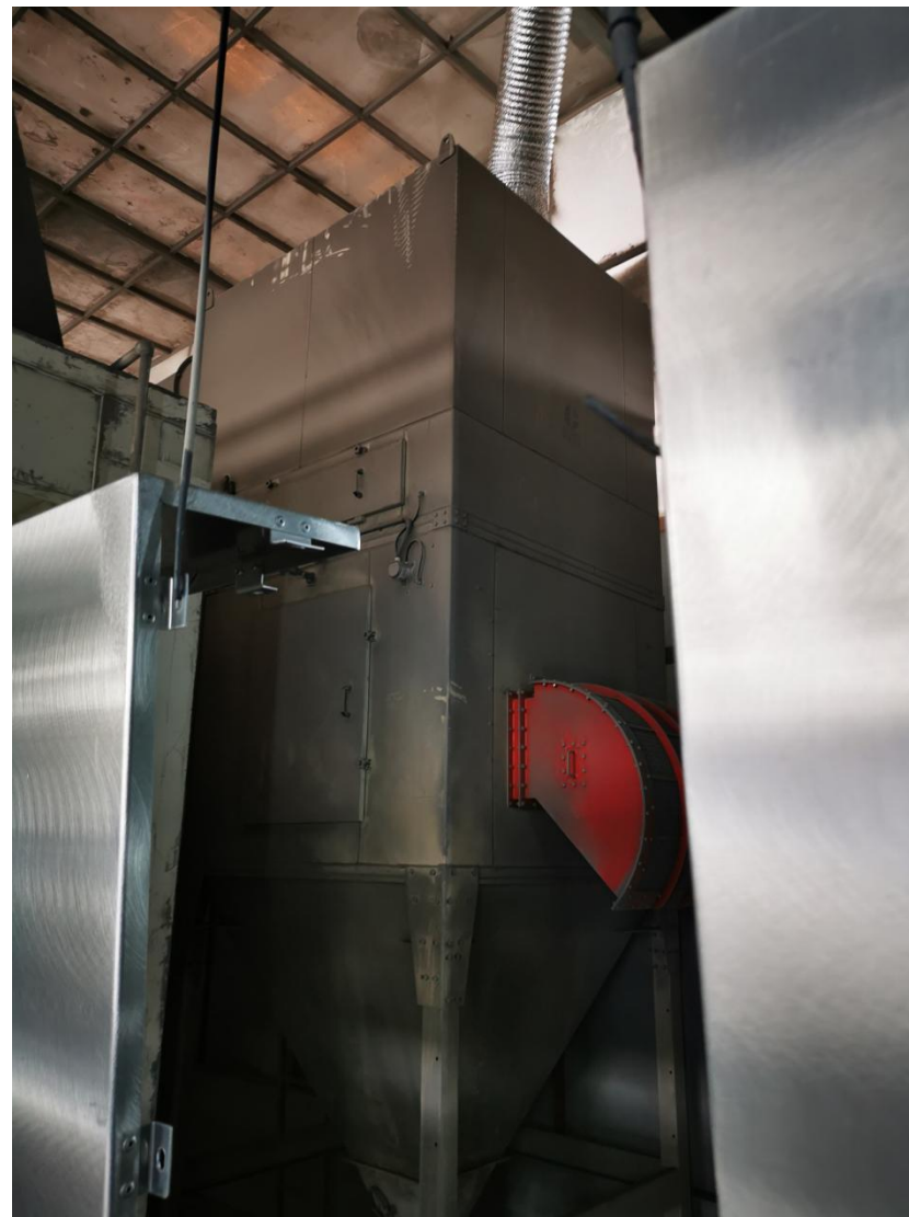
喷塑废气处理设施后端布袋除尘
