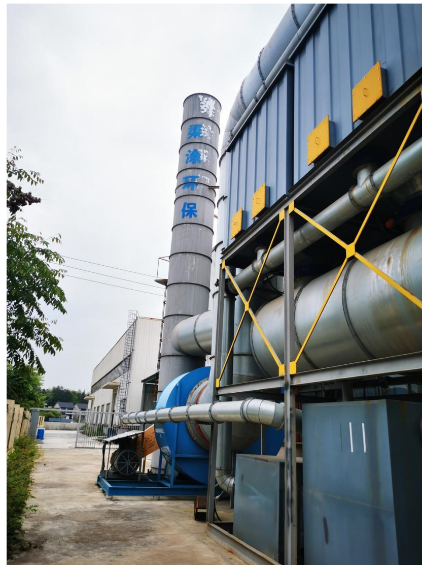
水旋塔+多级干式过滤器+活性炭吸附+TO 催化燃烧处理设施排放口
