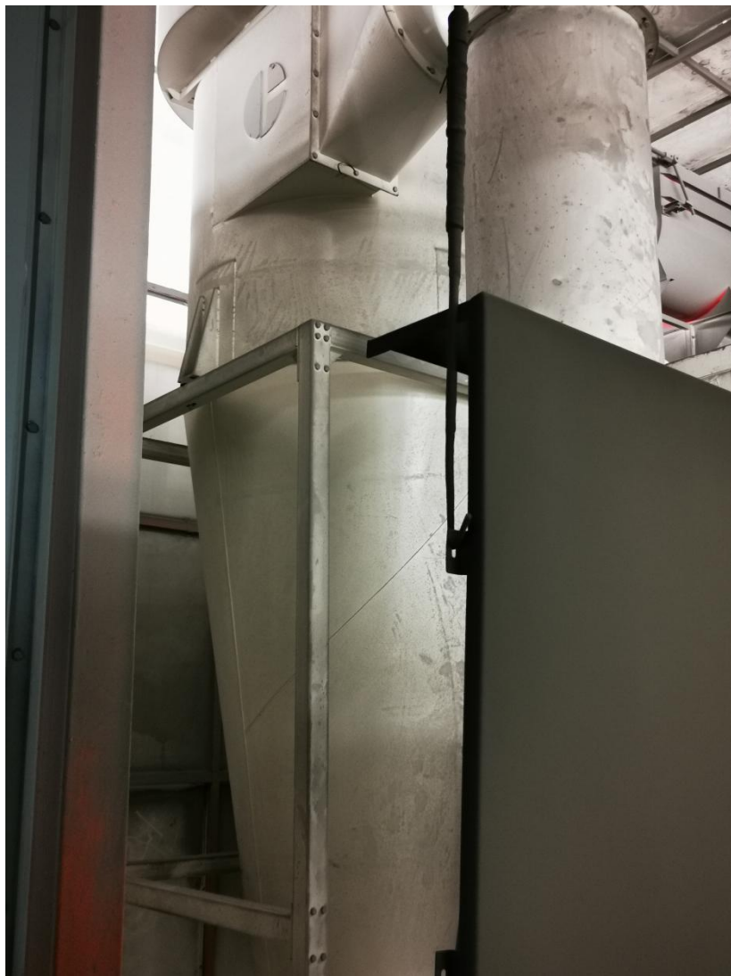
喷塑废气处理设施前端旋风除尘
