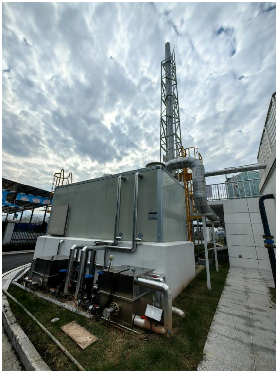
生物除臭装置
