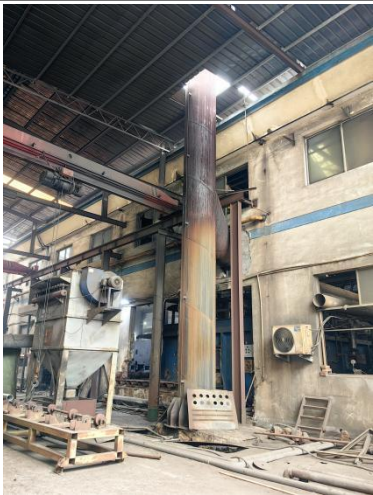
穿孔炉废气排放口
